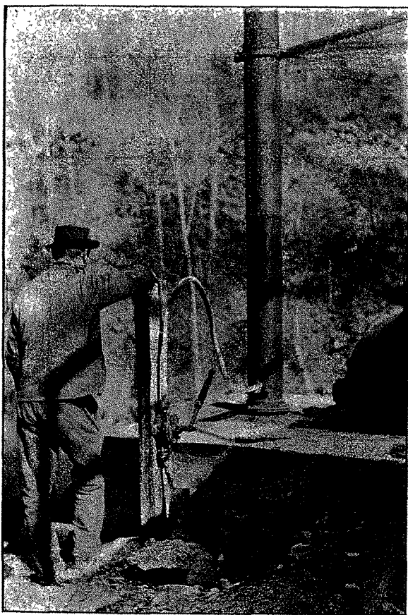
Fig. 5. — Pompe à main pour l'injection des ondes colorées dans la conduite des Allues.
