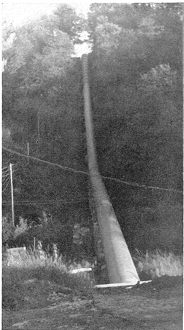
Conduite forcée de Pontcharra. Partie aérienne.
