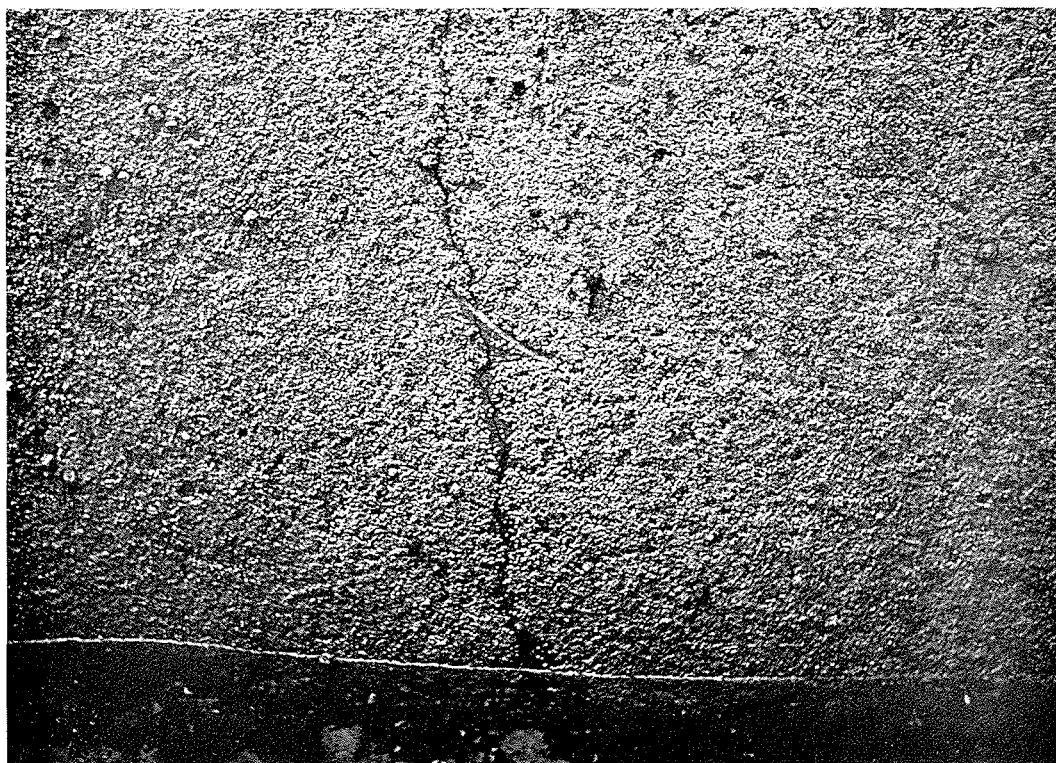
4/ Fissure non colmatée et non évolutive.
