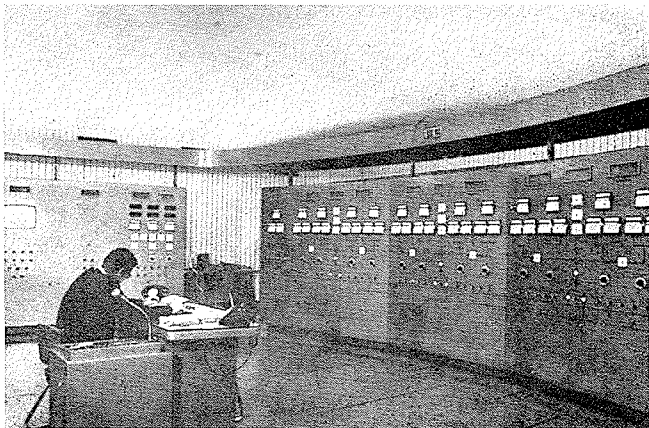
2/ La salle de commande centralisée
