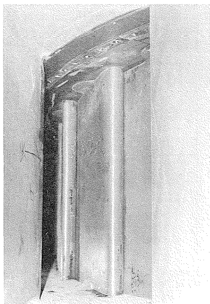
Figure 6 — Vue du distributeur de la bêche montrant la continuité du conduit à l'arête inférieure et au seuil de la vanne LG-2.
