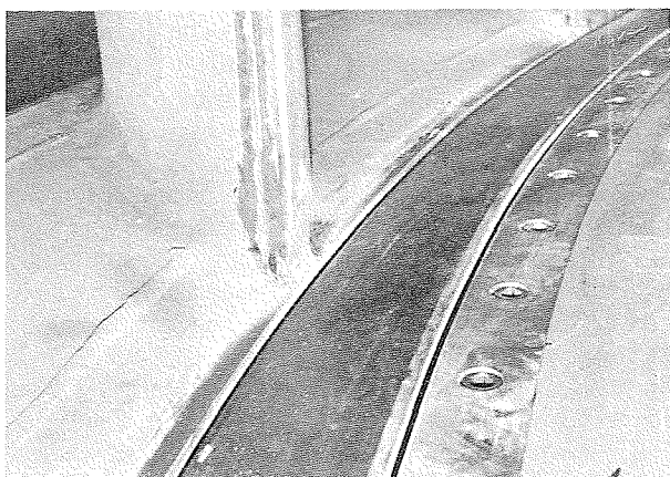
Figure 5 — Arête inférieure de la vanne ouverte et guide en bronze sur avant-directrice à la centrale LG-2
