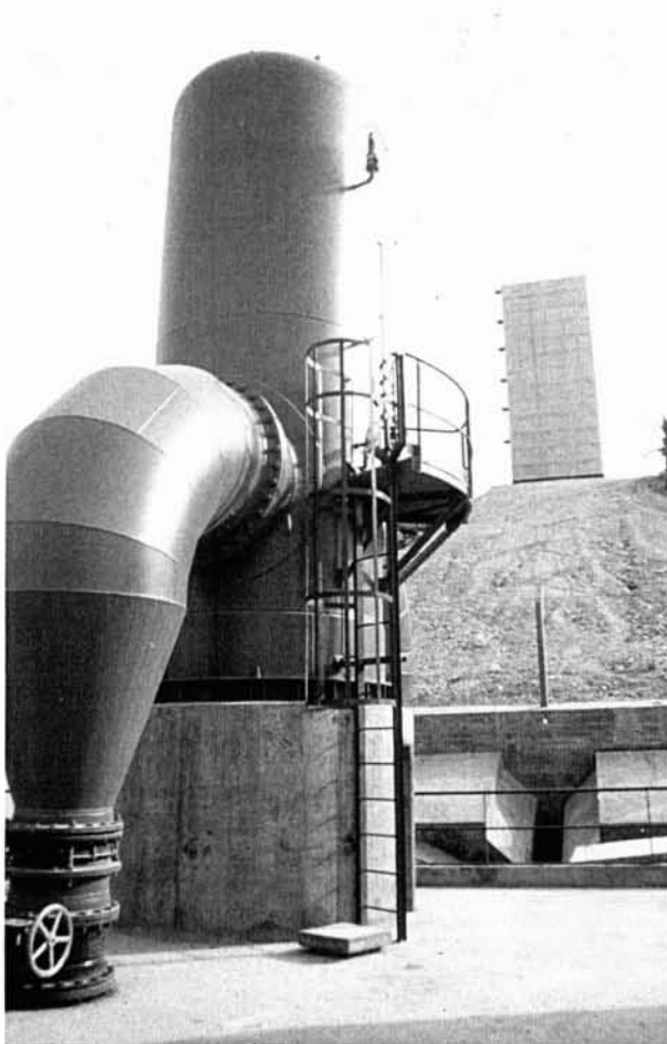
5. Installation de protection anti-bélier de Jorf Lasfar (Maroc).
