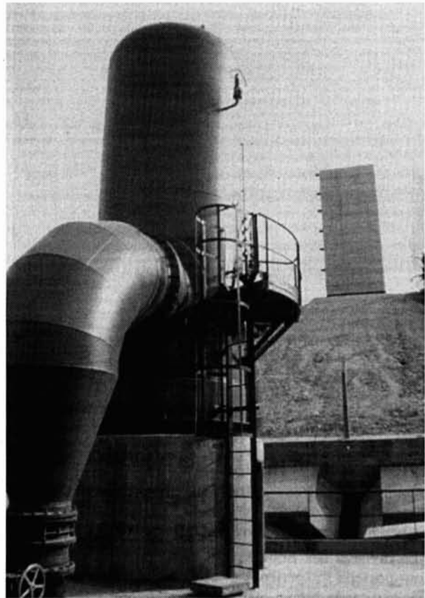
13. Installations de protection anti-coup de bélier.
