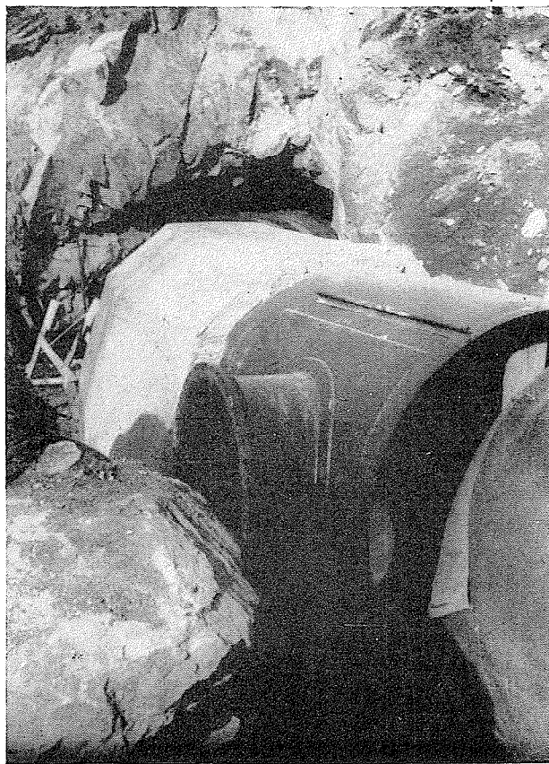
Fig. 13 Raccordement de la conduite avec la partie bétonnée en galerie entre le barrage et la centrale. (photo Chaudronneries des Pyrénées).
